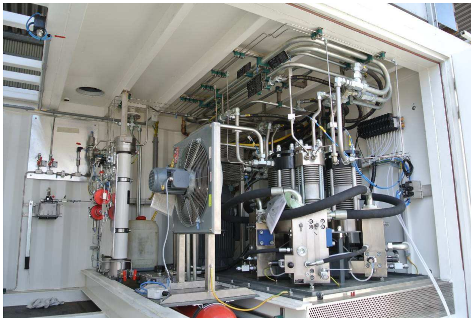
Abb.14: Verdichter 1 verbaut in Gesamtanlage
