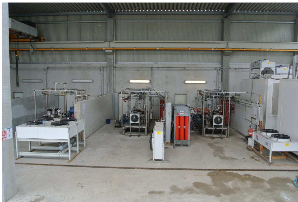
Abb.4: zwei fertig installierte Verdichter und eine Einheit in Arbeit (links äußerste Prüfbox)
