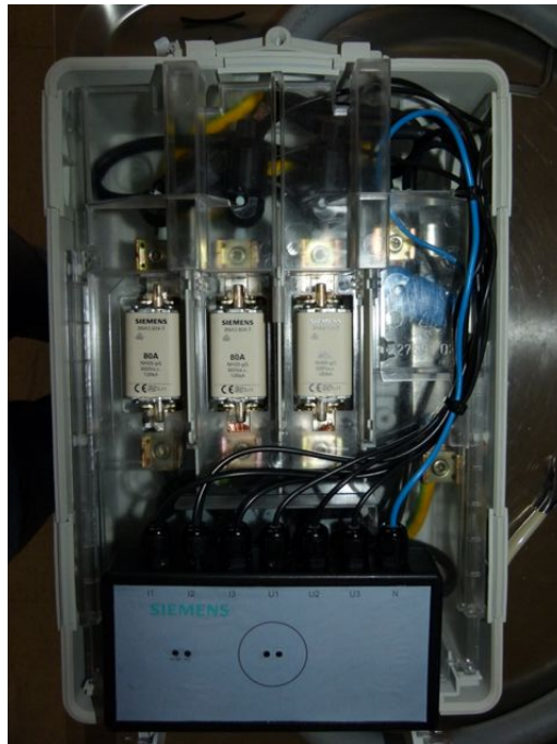
Abbildung 6: Eingebauter Messsensor im Hausanschlusskasten
