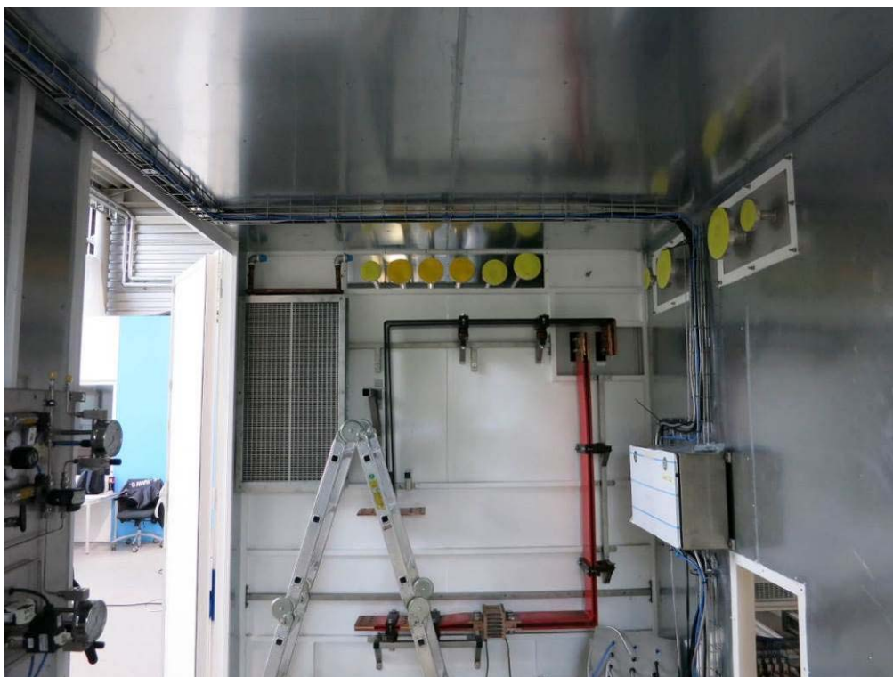
Abbildung 97: Blick in den Prozessraum auf Stromschienen
