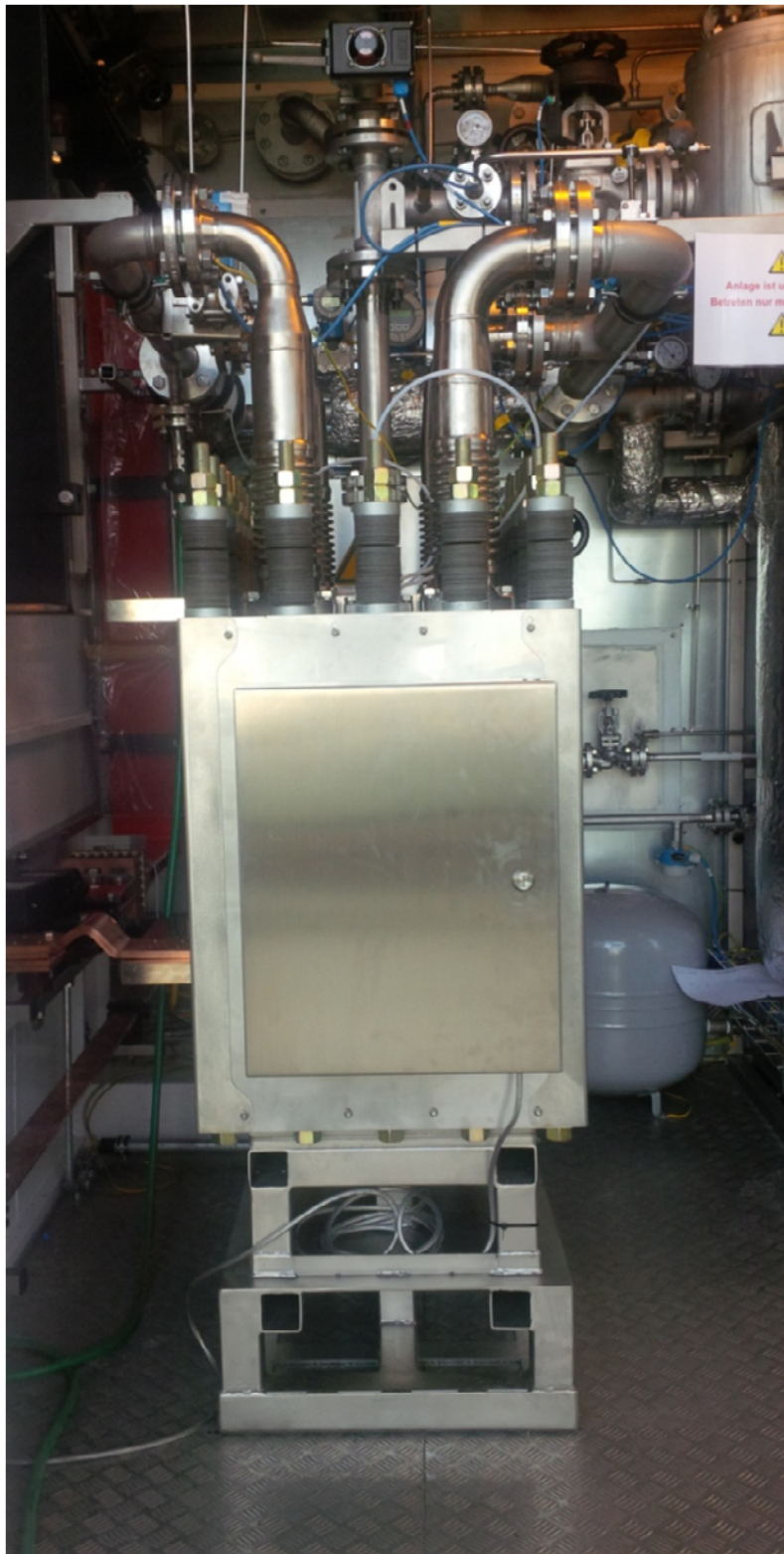
Abbildung 103: Integrierter 1 MW PEM Zellstapel mit Medienanschlüssen
