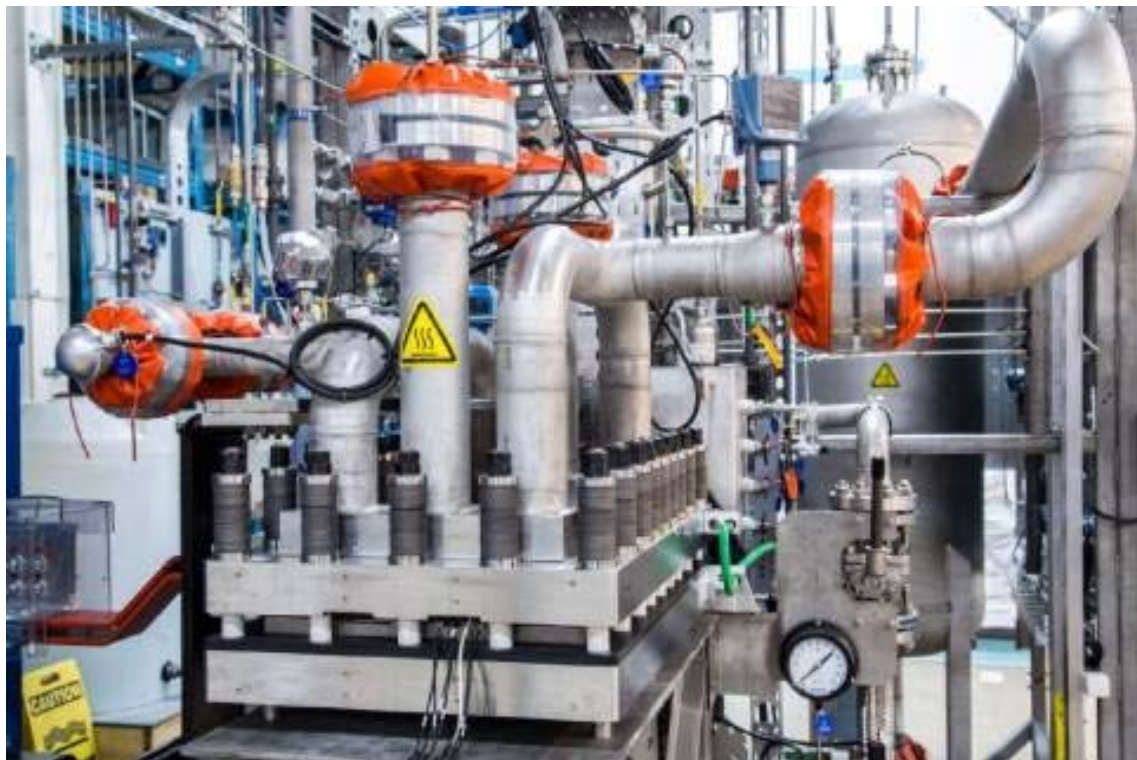
Abbildung 91: Kurz-Stack eingebaut im Teststand
