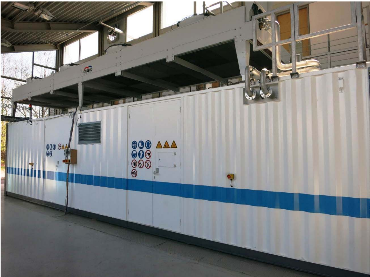
Abbildung 104: 40' Container mit Rückkühler vor der Inbetriebnahme
