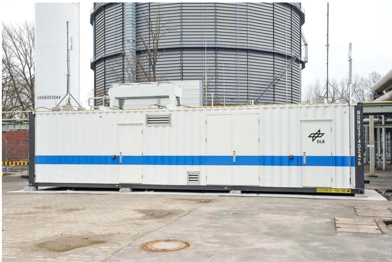
Abbildung 70: 50 kW Elektrolyse-Teststand in Stuttgart- Talstraße
