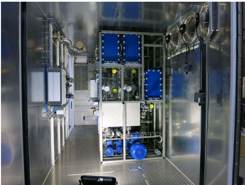
Abbildung 98: Blick in den Prozessraum mit Teilen des Primärwasserkreislaufes
