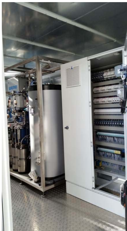
Abbildung 100: Blick auf die Anlagensteuerung und Wasseraufbereitungsanlage
