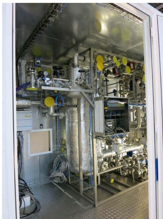
Abbildung 101: Blick in den Prozessraum ohne PEM Stack
