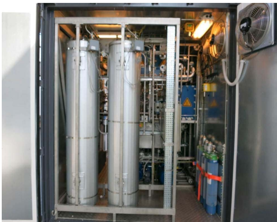
Abbildung 99: Blick in den Prozessraum auf die H 2 Trocknung
