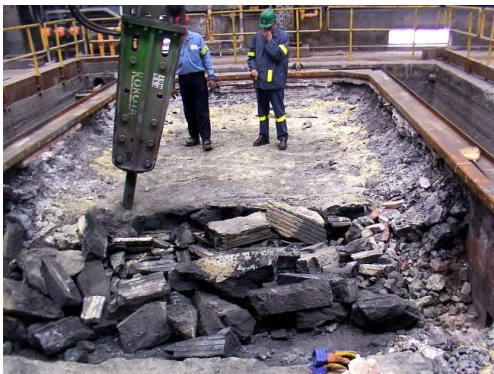
Abb.:1 Ausbruch Elektrolysezelle
