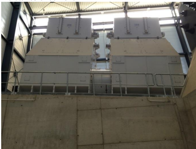
Abb. 10: 10 MW Antrieb auf dem Prüfstandsfundament
