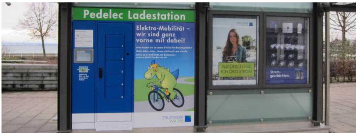
Abbildung 12: Pedelec Ladestation im Zentrum
