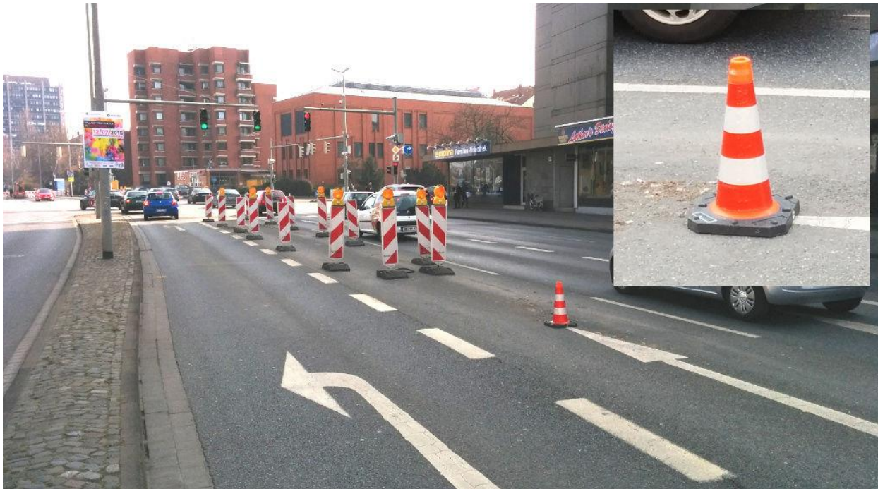
Abbildung 54: Einsatz des Intelligenten Leitkegels während der Integrationstests im Prüffeld Braunschweig, Zufahrt zur Forschungskreuzung K047 unter Ausnutzung einer aktuellen Baustellensituation
