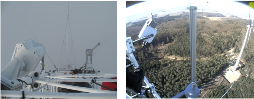
Abbildung 20: Eissensoren auf 135m, Kamera auf 140 m und benachbarte Anlagen
