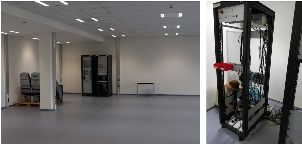
Abbildung 46: Aufbau und Modifikation des vorhandenen Kabinenmanagement-Systems im ZAL TechCenter
