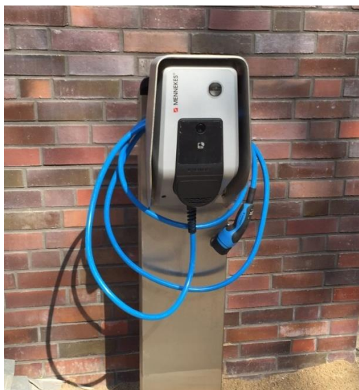
Abbildung 24: Ladestation im VHD. Bei direkter intensiver Sonneneinstrahlung heizt sich das Gehäuse innen auf über 50°C auf und die Elektronik schaltet aus Sicherheitsgründen ab.
