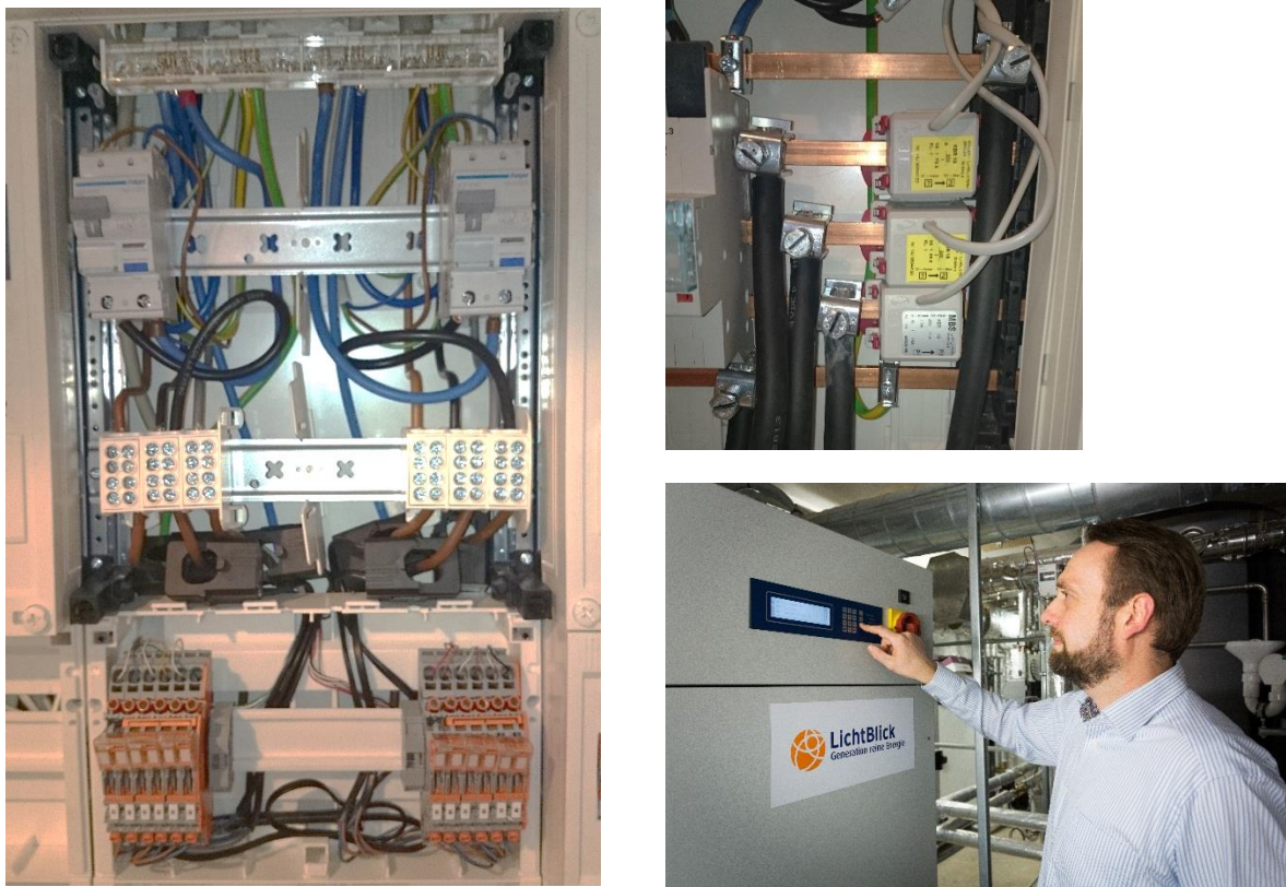
Abbildung 6: Unterverteilung mit Klappstromwandler und Prüfklemmen für die Messtechnik der dezentralen Optimierung (links) sowie die unabhängige Messung des gesamten Verbrauchs für die Eigenregelung des stationären Batteriespeichers (rechts, oben) und das BHKW im Vogelhüttendeich (rechts, unten).
