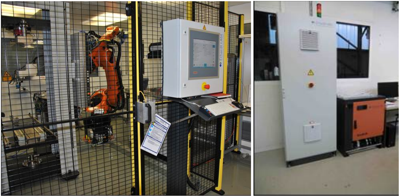
Abbildung 26: Sicherheitszaun mit Steuerungstechnik (links); Schaltschrank (rechts)
