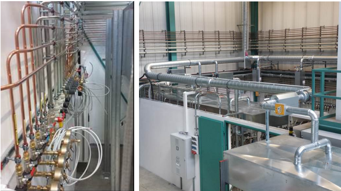
Abbildung 6: Ausschnitt Gas-, KW- und Deminwasserversorgung für zwei der neuen Teststände (links); Abluftanlage der neuen Teststände (rechts)
