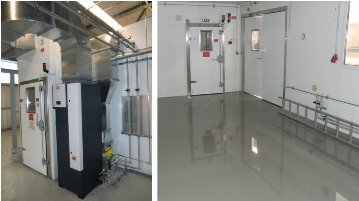
Abbildung 15: Klimagerät vor dem Montage Raum (links), Montage Raum ohne Geräte (rechts)
