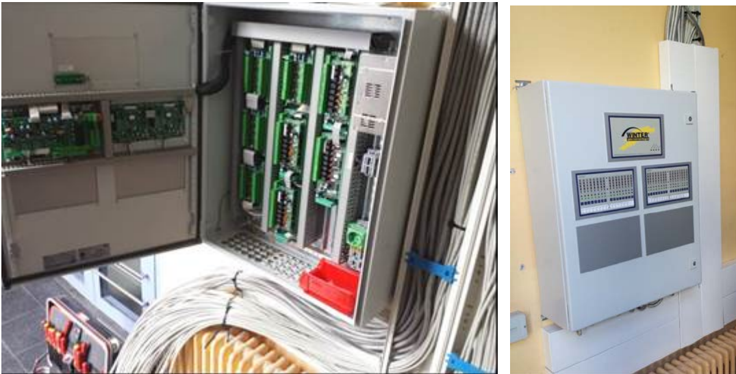
Abbildung 7: Gaswarnanlage für die neuen Teststände
