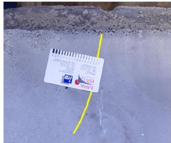
(b) Rissbildung im oberen Bereich (0,2 mm)
