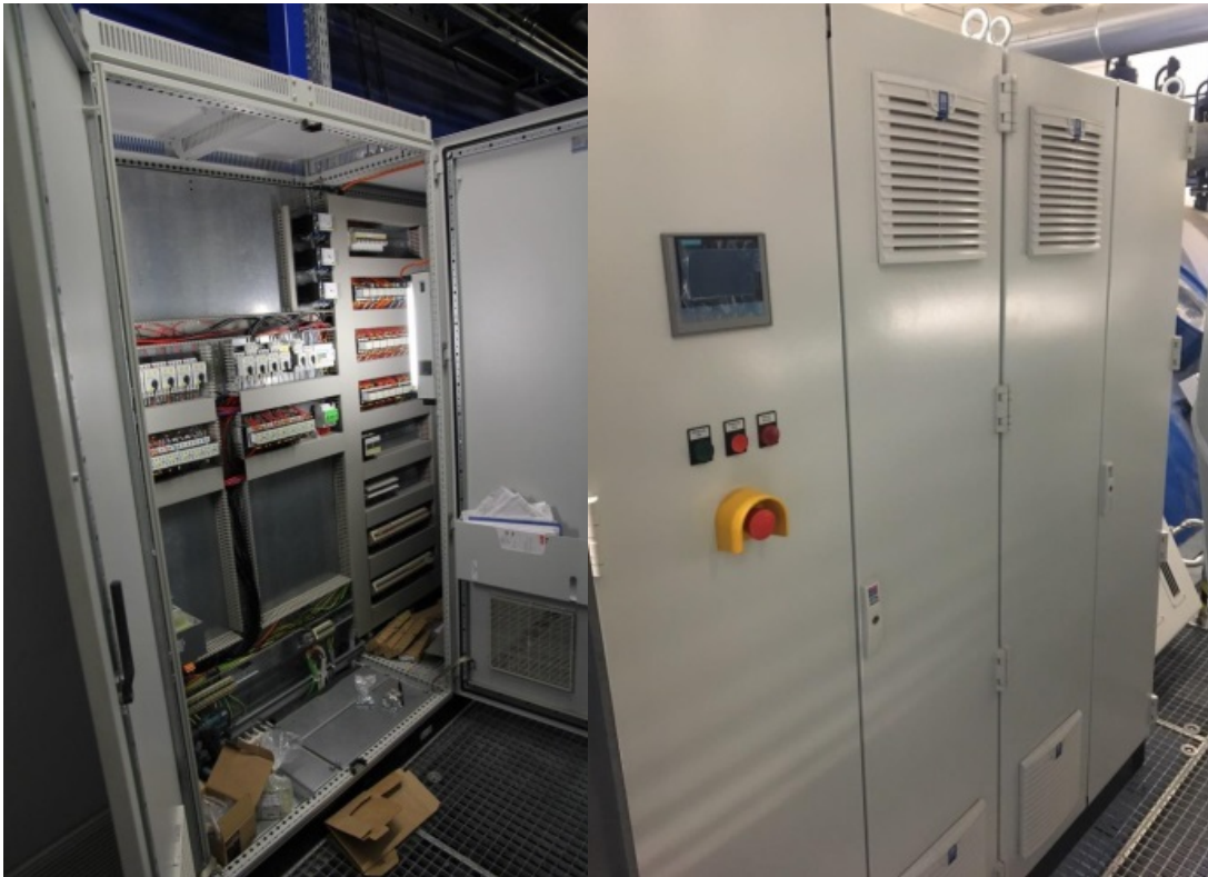
Abbildung 67 a & b: Schaltschrank für die Heizungsregelung [3]
