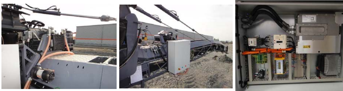
Bild 166: Links und Mitte: Generator, Rechts: Innenansicht des Schaltschranks
