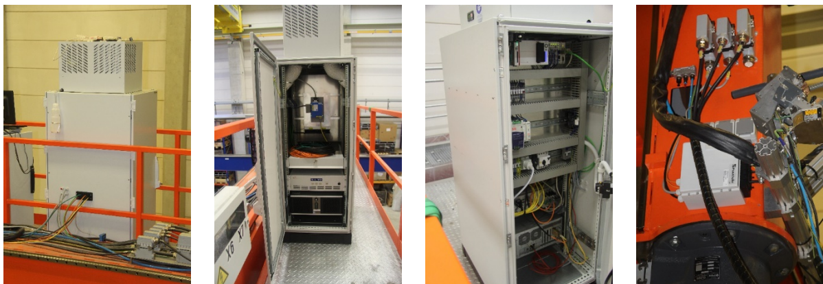
Abbildung 80 Prozessvisualisierungssystem auf der dritten Portalbrücke sowie Umsetzerbox für Datenübertragung und Ansteuerung der Kamera
