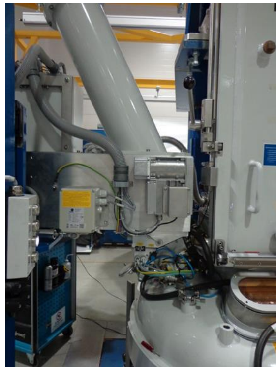
Abb.101: Mobiler Feeder im angedockten Zustand
