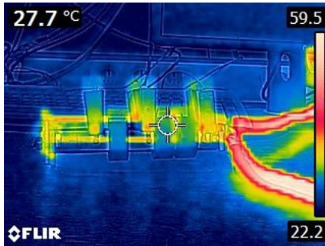
Abbildung 83: Thermische Messungen des Filters bei Maximalstrom
