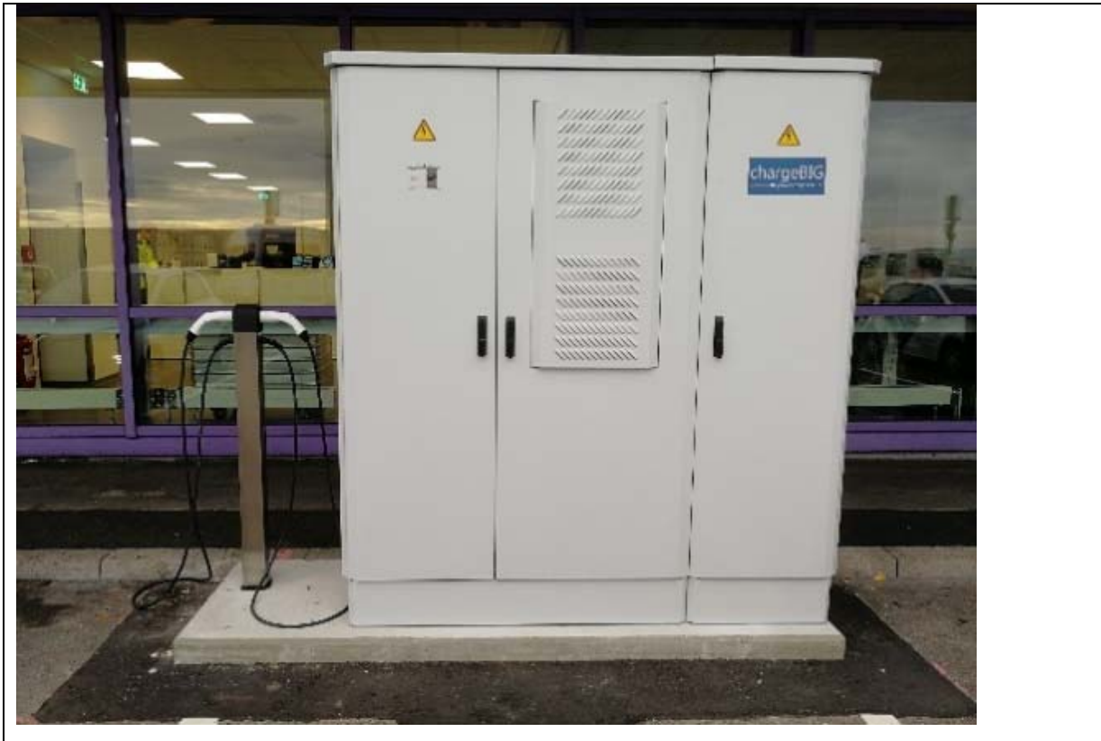
Abbildung 3-22: Installierte Ladeinfrastruktur VL-Gebäude mit Mahle ChargeBig
