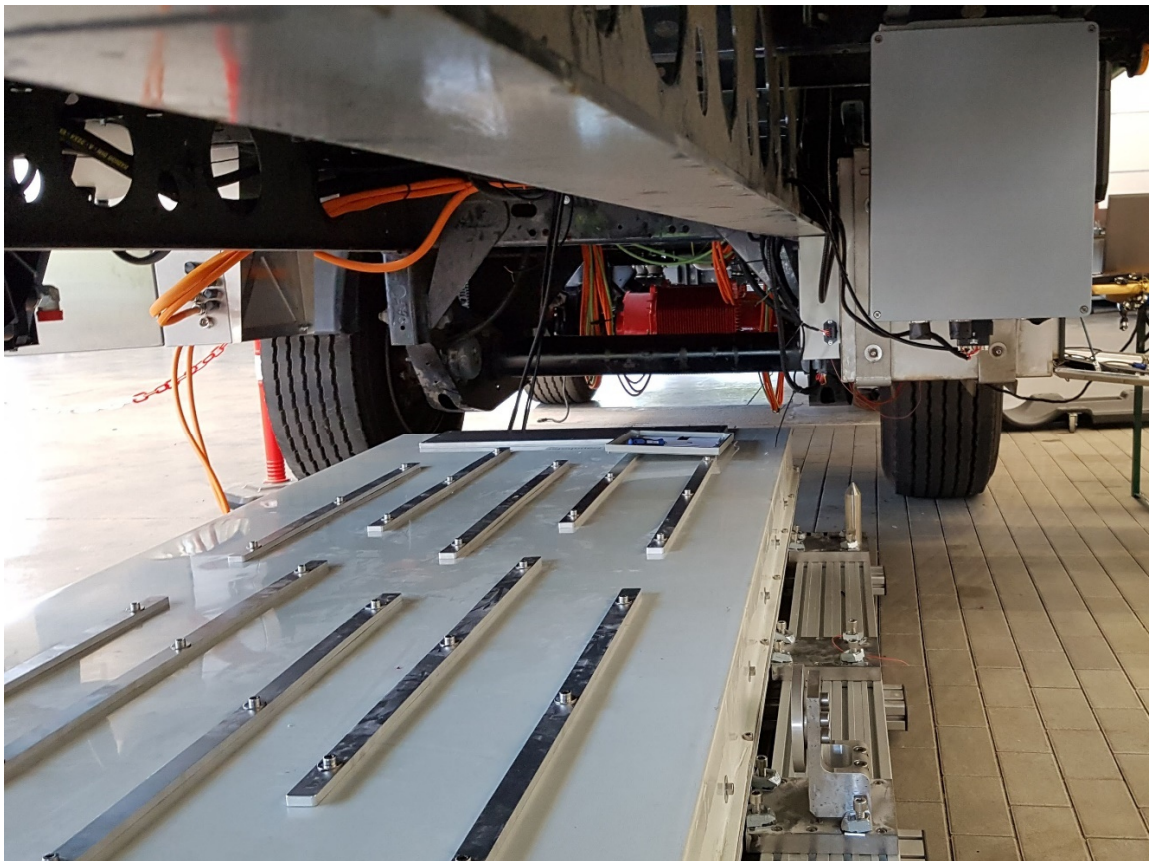
Bild 11: Batteriesystem vor dem Einbau zwischen den Längsträgern
