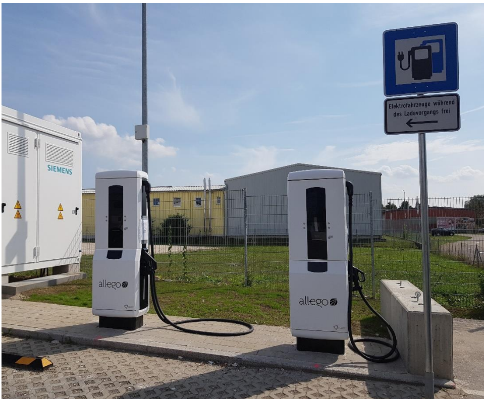
Abbildung 64 Bedieneinheiten 500 A (links) und 200 A (rechts) Jettingen-Scheppach
