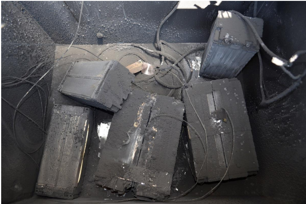
Abbildung 12: Ausgebrannte Batteriemodule nach Versuch
