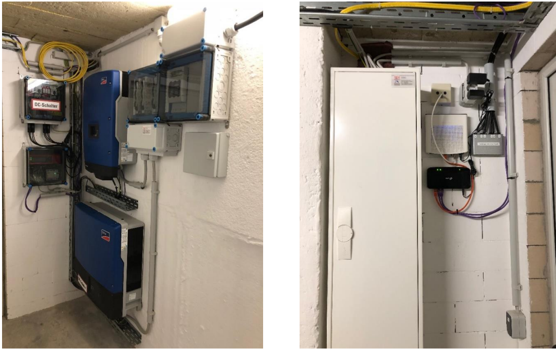
Abbildung 12: Elektroraum Alfons-Pech-Straße 24, links: PV-Wechselrichter und Kommunikationseinheiten PV, rechts: Bildausschnitt zentraler Elektroschaltraum.
