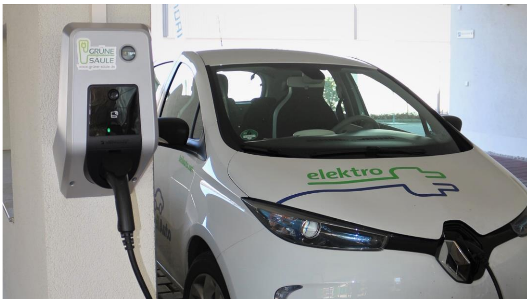
Abbildung 25: Eine der vier Wallboxen im Innenhof des Geschäftsgebäudes der CSg.
