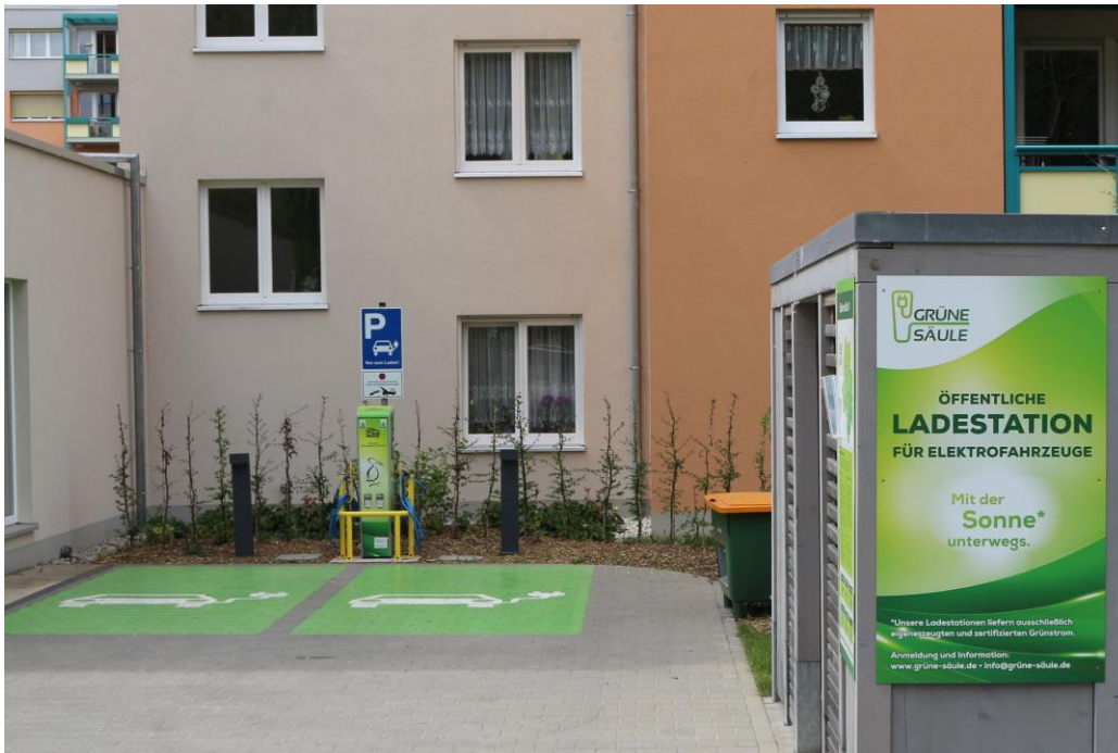
Abbildung 22: Ladeinfrastruktur Grüne Säule am CSg-Objekt Eislebener Straße 11.
