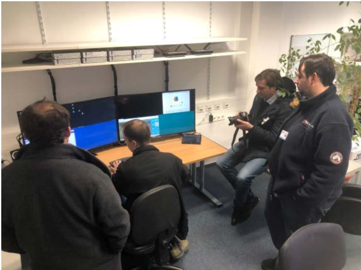
Blick auf die Installation der Leitstelle bei G&D durch das Kernprojektteam
