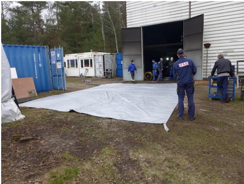
Abbildung 41: Typ A- Brandbegrenzungsdecke, vor dem Zerschneiden
