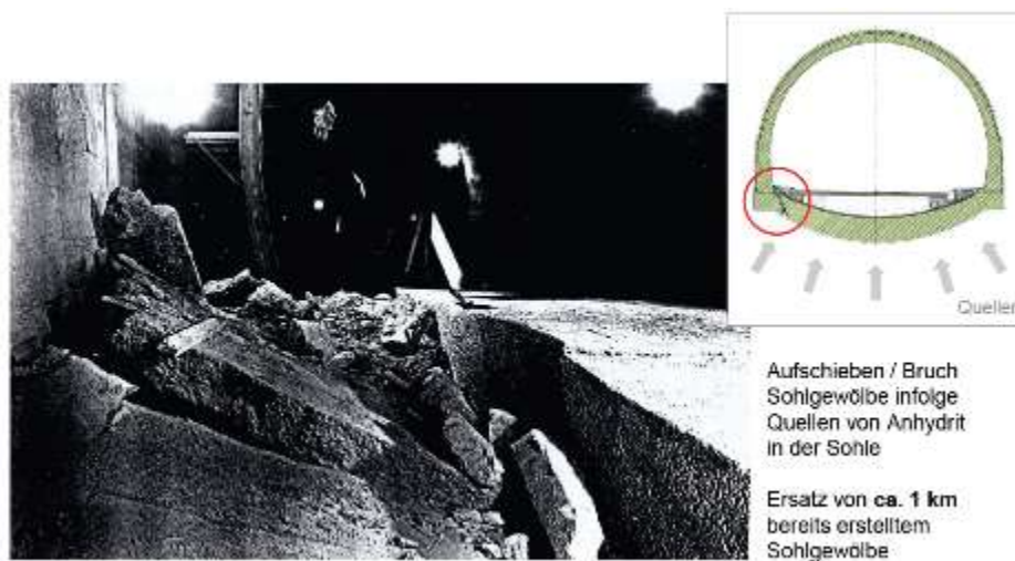
Abbildung 2-13: Schadensbild während der Bauphase des Belchentunnels (Chiaverio et.al., 2018)
