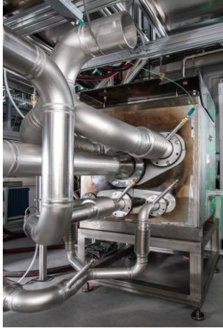
Abbildung 21: Hochtemperaturverrohrung der Stack Unit
