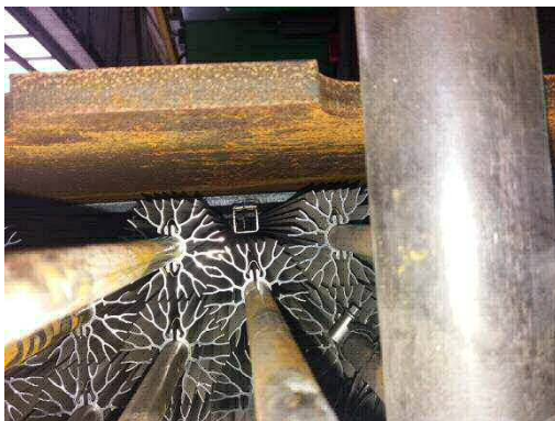
Abbildung 4-26: Mittig im Bild ist ein Transportsicherungselement zu sehen, eingeschweißt an der Wand des Speichers.
