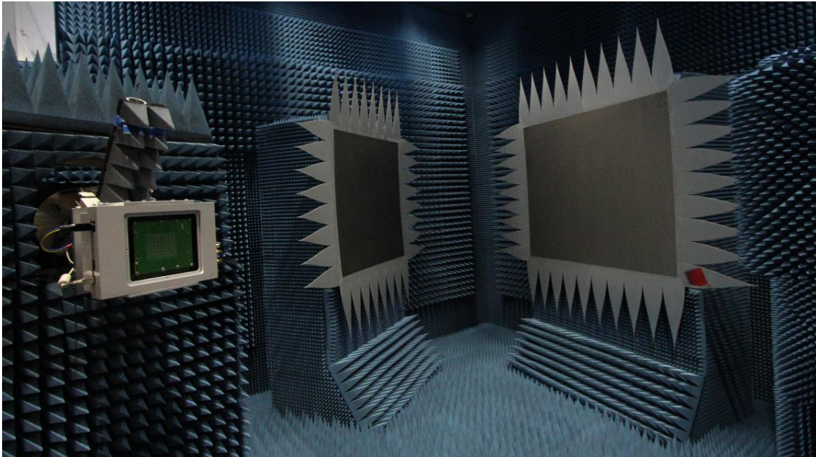
Abbildung 27: Anechoic CCR Kammer für die Antennenabstrahlanalyse
