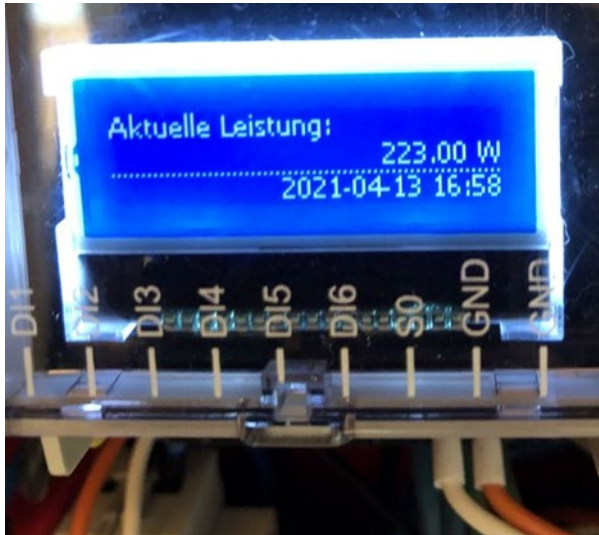
Abbildung 48: Blick in den Schaltschrank - Moment der Inbetriebnahme
