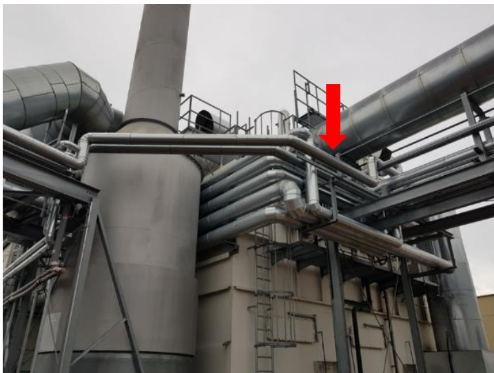
Abbildung 7: Einspeisung des \mu GT-Abgases kurz vor der RTO-Anlage
