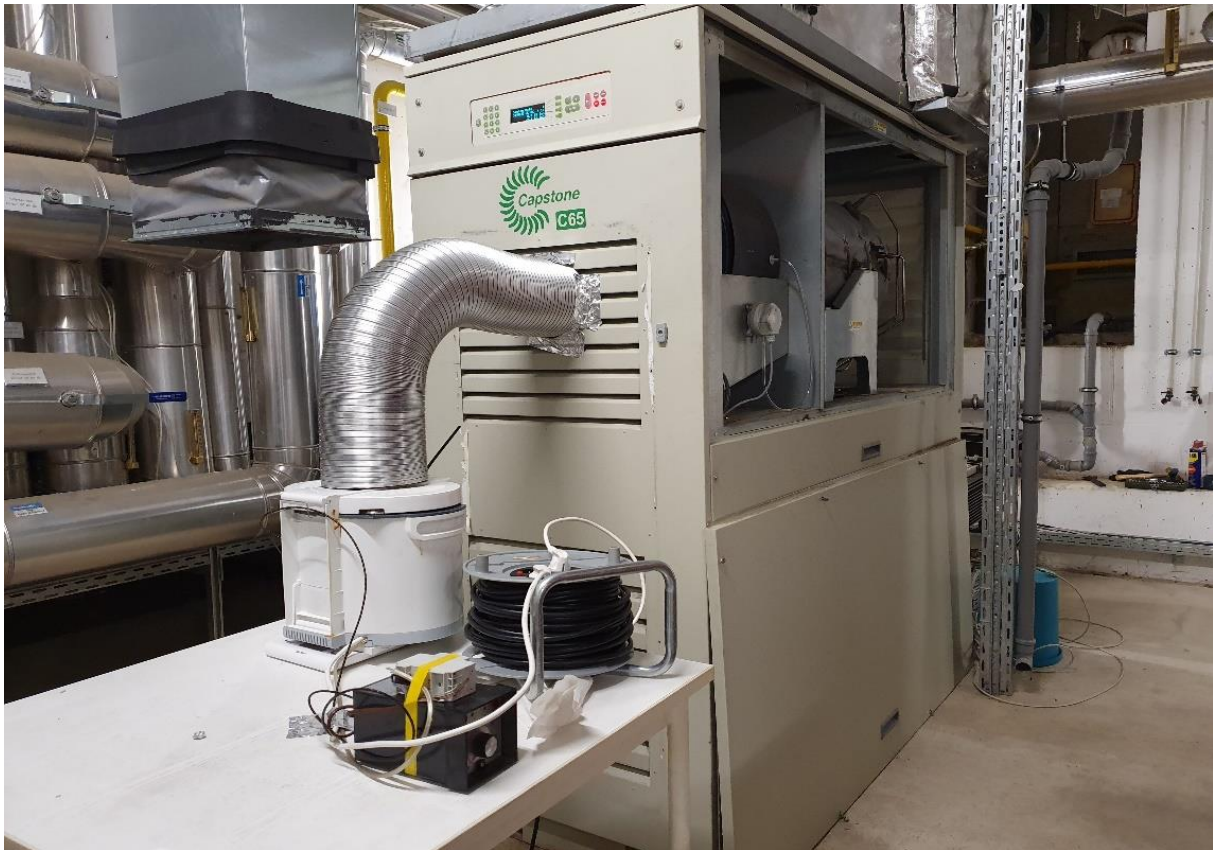
Abbildung 12: Verbrennungsluftansaugung über Verdampferbad und Ansaugrohr
