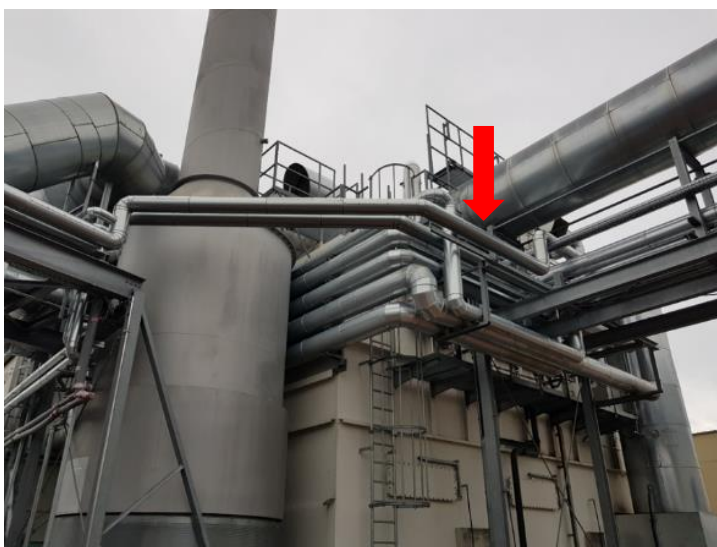
Abbildung 7: Einspeisung des \mu GT-Abgases kurz vor der RTO-Anlage
