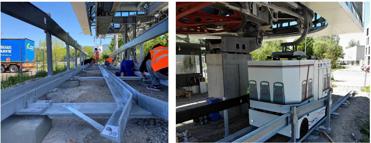
Abbildung 62: Ausrichtung der Führungsschienen (links). upBUS-Technologiedemonstrator am Seilbahnteststand mit Seilbahngehänge, Kabine und Fahrmodul (rechts).
