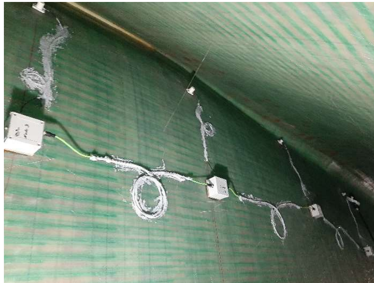
Abbildung 96: Installierte Sensorknoten im Rotorblatt der Offshore Windenergieanlage
