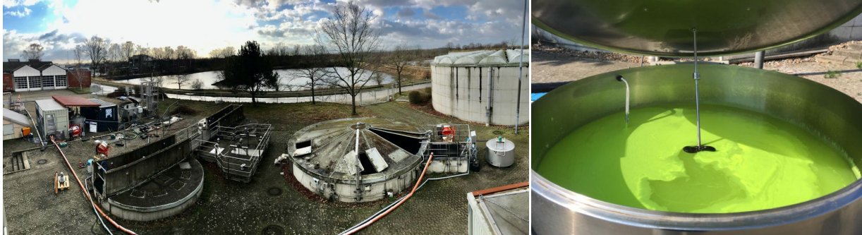
Abbildung 2-32: Links: Blick auf das Gelände der Versuchskläranlage mit Belebtschlamm-system sowie MBR und Polstofffilter in Containerbauweise (hinten links), daneben Mikrosieb und Sandfilter; rechts: Vorlagebehälter mit Suspension aus PE, Wasser und Ethanol (Fotos: ISWW, S. Meyer, 2019)
