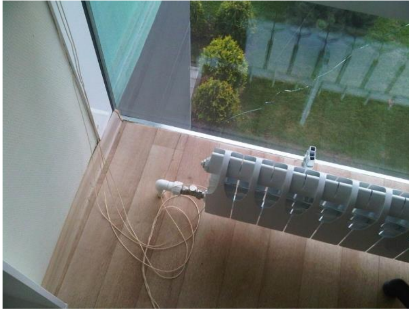
Abbildung 4-6: Thermisch induzierter Bruch an einem Zweifach-Isolierglas in einem Bürogebäude (Quelle: AGC Interpane).
