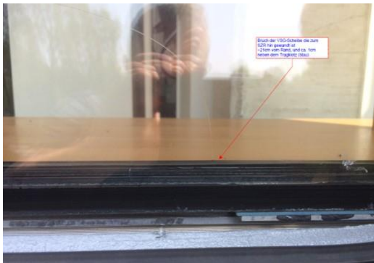
Abbildung 4-5: Thermisch induzierter Bruch an einem Sonnenschutzglas - Detail (Quelle: AGC Interpane).
