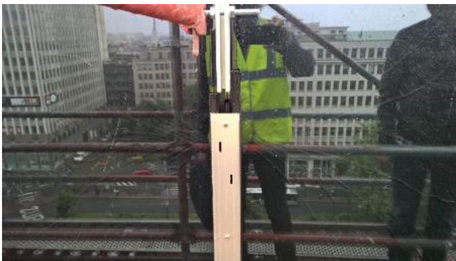
Abbildung 4-3: Thermisch induzierter Bruch an einer Brüstungsverglasung (Quelle: AGC Interpane).
