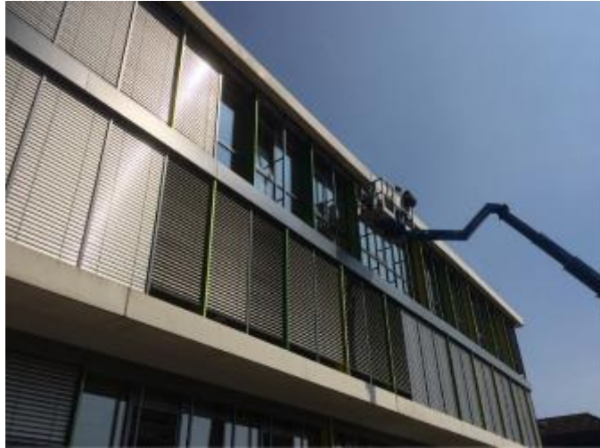
Abbildung 4-4: Thermisch induzierter Bruch an einem Sonnenschutzglas - Übersicht (Quelle: AGC Interpane).
