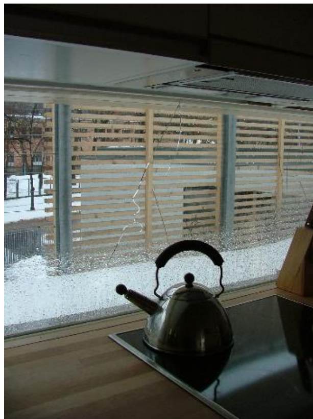
Abbildung 4-7: Thermisch induzierter Bruch an einem Zweifach-Isolierglas in einem Wohngebäude (Quelle: AGC Interpane).
