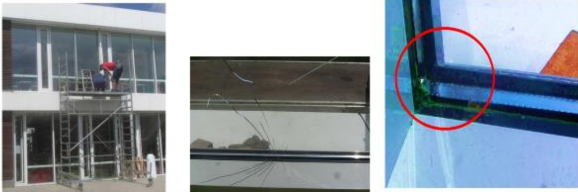
Abbildung 4-8: Thermisch induzierter Bruch an einem Dreifach-Isolierglas in einem Kindergarten (Quelle: AGC Interpane).
