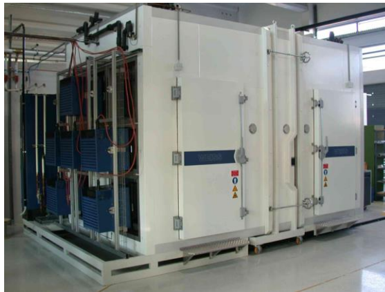
Abbildung 8-1: Sicht auf die Doppel-Klimawechselkammer im TestLab PV Modules am Fraunhofer ISE mit Außenmodul (linke Kammer) und Innenmodul (rechte Kammer).
