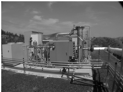
Gasaufbereitung für Deponiegas zur Versorgung von 10 Mikroturbinen à 30 kW el.
