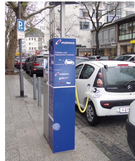
Mainova Stromtankstelle mit Parkscheinautomat in der Bleidenstraße 6–10 in Frankfurt am Main. Quelle: ABGnova GmbH, 2011
