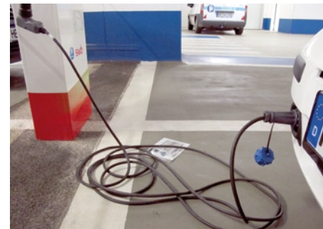
Potenzielle Stolper- und Gefahrenquellen an Ladesäulen: Kabel Quelle: Glotz-Richter, 2011
