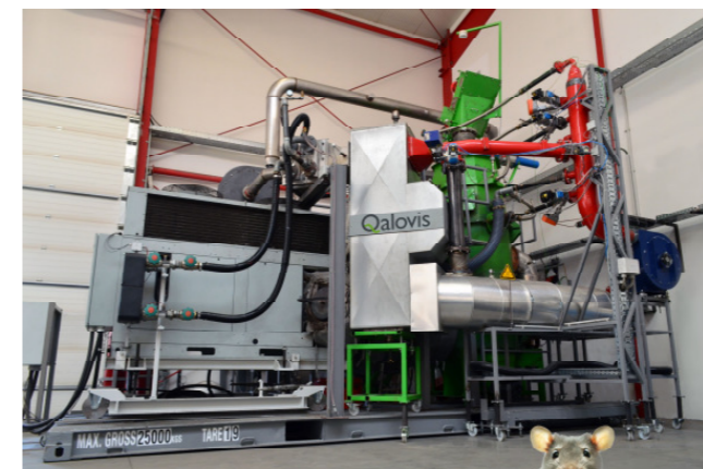
Abb. 1: Versuchs- und Demonstrationsanlage des Q-PowerGen
