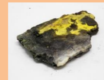
Salzangriff auf Feuerbeton
