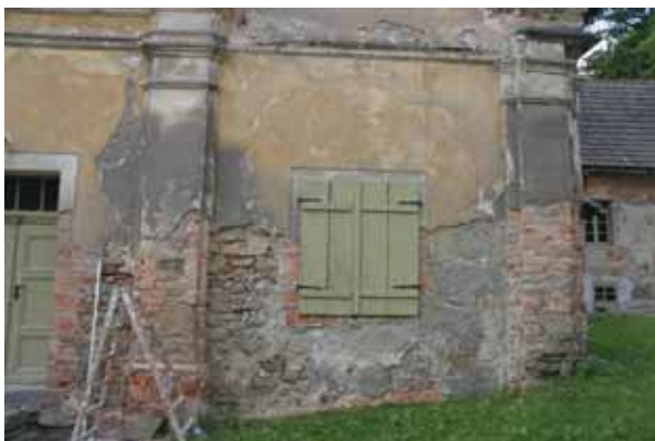
Abb. 59 Beamtenhaus, Giebel, rechtes Fenster mit umlaufendem Riss
