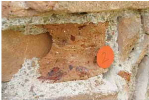
Abb. 55 Beamtenhaus, Giebel, Pilaster, Schäden an einzelnen Ziegeln
