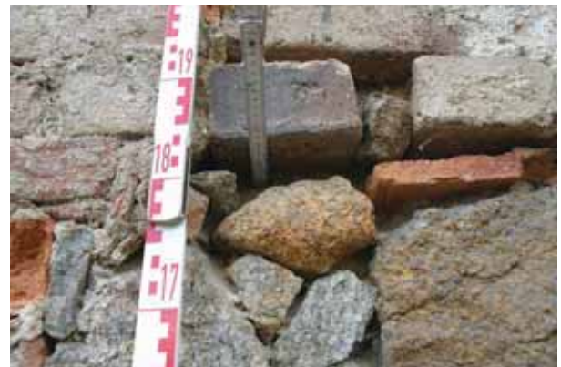
Abb. 58 Beamtenhaus, Giebel, Fassade rechts neben Tür, Fugenmörtel auswaschungen bis zu 10 cm
