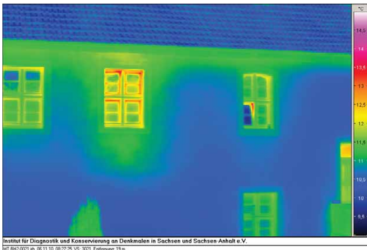
Abb. 78 Südwestfassade Haupthaus, gleichmäßige Verteilung der Oberflächentemperaturen
