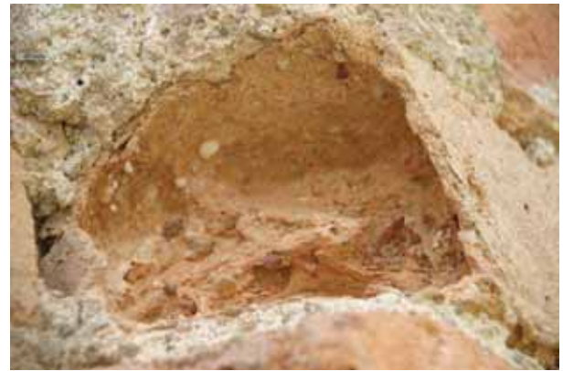
Abb. 56 Beamtenhaus, Giebel, Pilaster, Schäden an einzelnen Ziegeln
