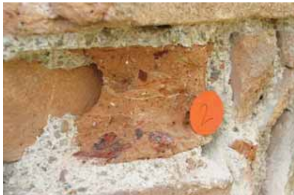
Abb. 22 Beamtenhaus, Giebel, Pilaster, Schäden an einzelnen Ziegeln
