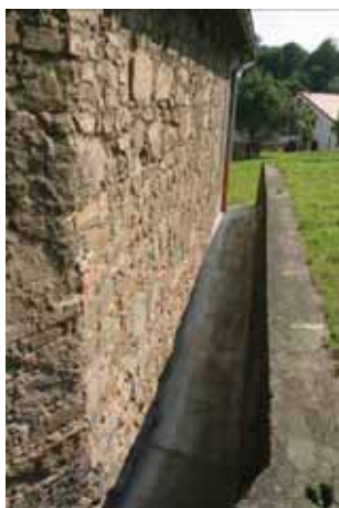
Abb. 8 Haupthaus, Graben am rechten Bereich der Nordwestfassade, 25.06.2010
