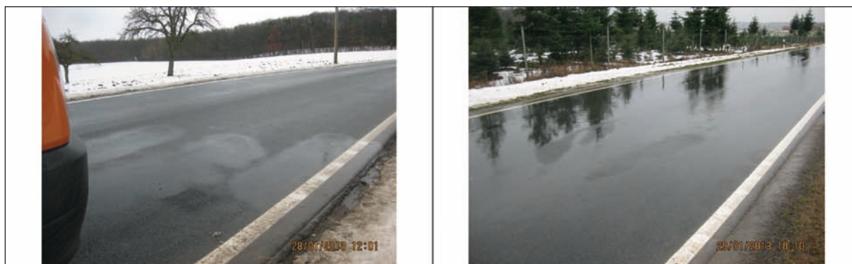
Bild 120: Nasser Fahrbahnzustand auf der Wü9a am 28.01.2013 (links) und am 29.01.2013 (rechts), SM Würzburg
