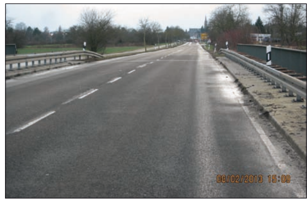
Bild 58: Brückenbauwerk auf der Grabener Straße mit Wasseransammlung am Randstreifen, KW 06-2013, Karlsruhe
