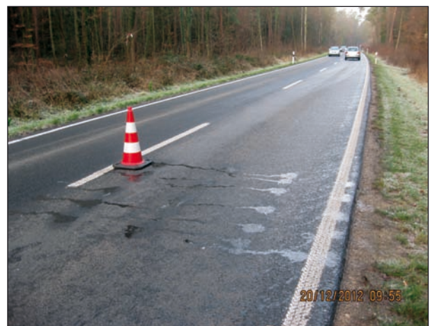
Bild 51: Fahrbahnzustand auf der L 604 in Fahrtrichtung A, KW 51-2012, Karlsruhe
