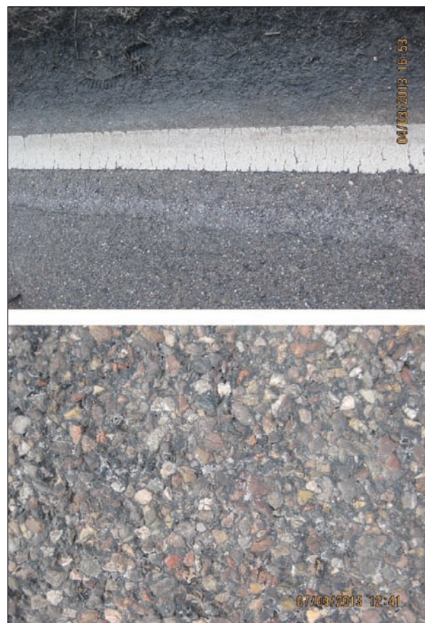
Bild 113: Salzfilm auf der Fahrbahn
