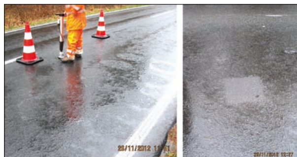
Bild 34: Nasser Fahrbahnzustand der L 604 am 26.11.2013, KW 48-2012, Karlsruhe
