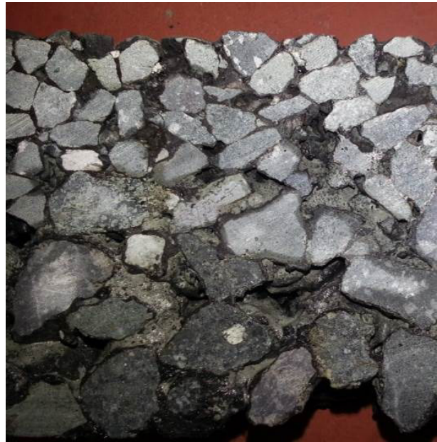
Bild 19: Beispiel für einen stark verschmutzten PA (zweilagiger offenerporiger Asphalt auf der Westlichen Ringstraße in Ingolstadt)
