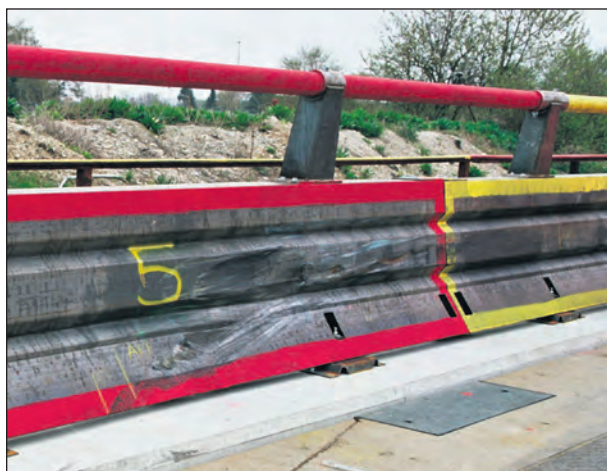
Bild 45: System F: Kontaktstrecke nach Prüfung TB 11 mit Systemschäden
