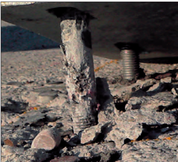
Bild 48: Oberflächliche Abplatzung durch Herausziehen des Ankers
