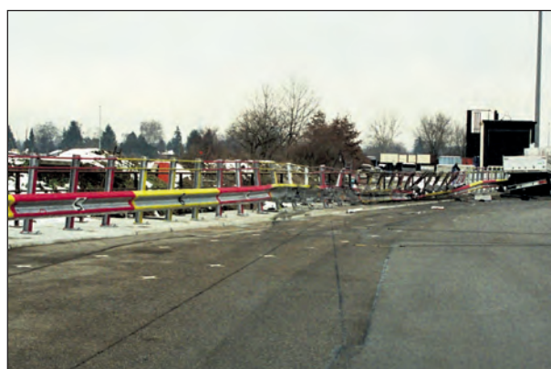
Bild 42: System E: Kontaktstrecke nach Prüfung TB 81 mit Systemschäden
