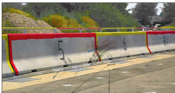
Bild 20: System A: Kontaktstrecke nach Prüfung TB 11 mit Systemschäden
