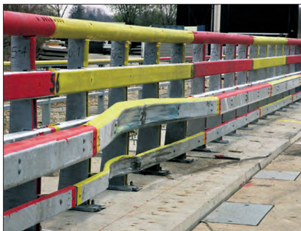
Bild 30: System C: Kontaktstrecke nach Prüfung TB 11 mit Systemschäden
