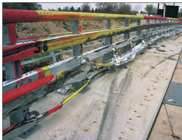
Bild 32: System C: Kontaktstrecke nach Prüfung TB 81 mit Systemschäden
