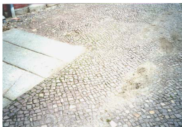
Gehweg (unbefestigt, stark verschmutzt)
