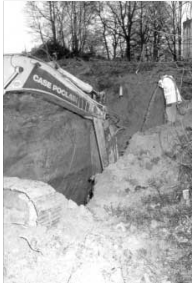
Bild 4: Herstellung eines Stützkörpers. Zugabe von Zementsuspension und Durchmischung mit Boden mit der Baggerschaufel
