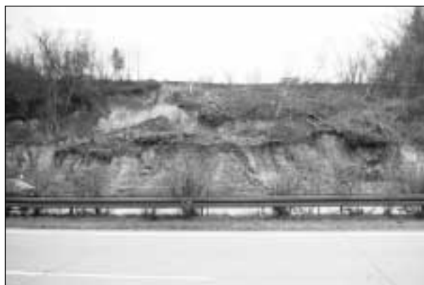
Bild 2: Ansicht der Rutschung nach Räumung der Fahrbahn
