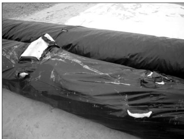
Bild 2: Beim Transport auf der Baustelle beschädigter Geokunststoff
