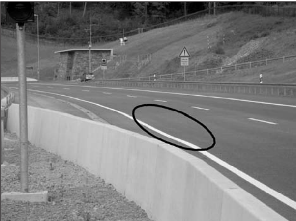
Bild 4: Schadensbild der Straße
