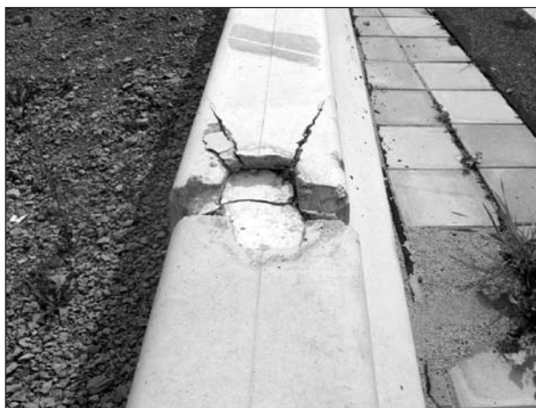
Bild 3: Schadensbild an der Betonschutzwand
