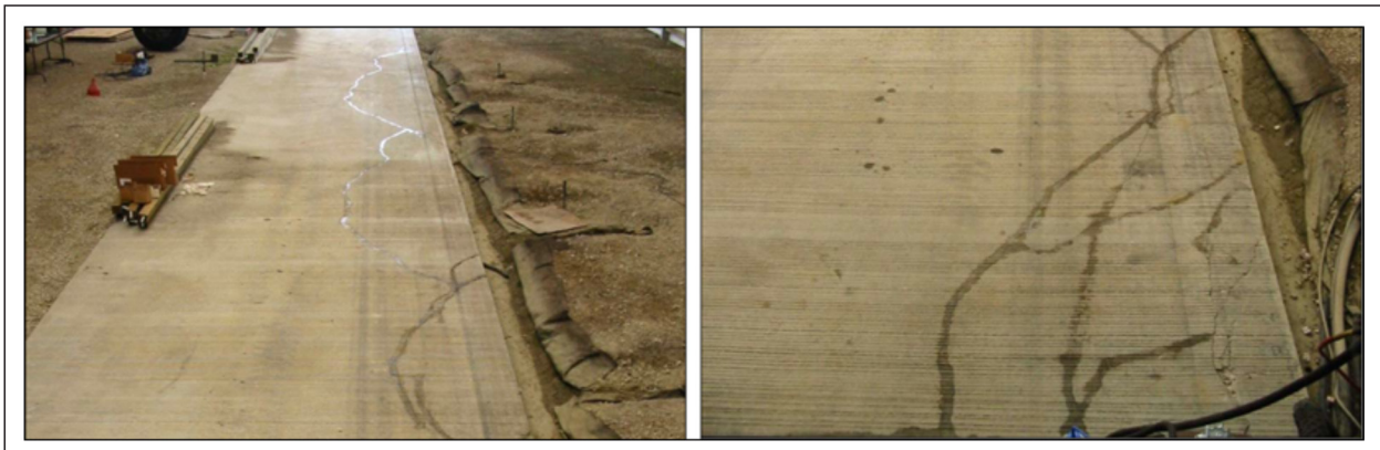
Bild 2–3: Besprühen der Einbaustrecke mit Wasser zur besseren Sichtbarkeit der sichelförmigen Risse [15]
