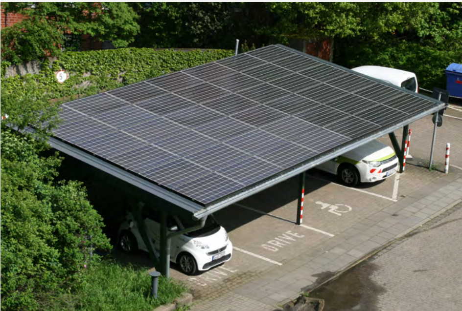
Abbildung 3: Solar Carport mit integrierten Ladepunkten am Umweltamt der Stadt Düsseldorf (Foto: Umweltamt Düsseldorf)
