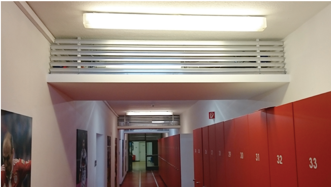
Abb. 53 Flur mit Überströmkanälen
