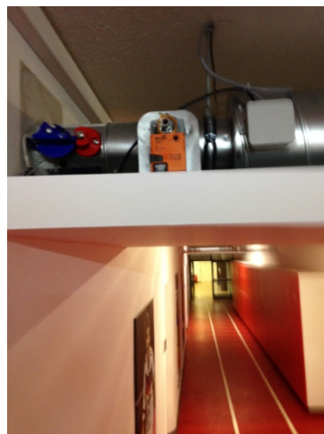
Bild 9 Überströmkanal mit Überströmklappe und Schrittmotor
