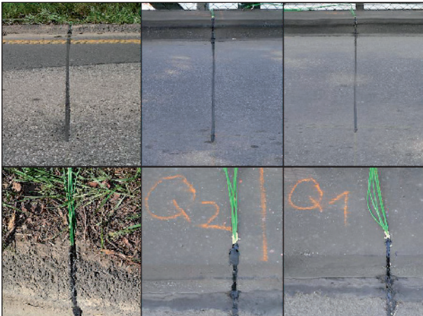
Bild 11: Sensoren und Verkabelung Q3, Q2, Q1
