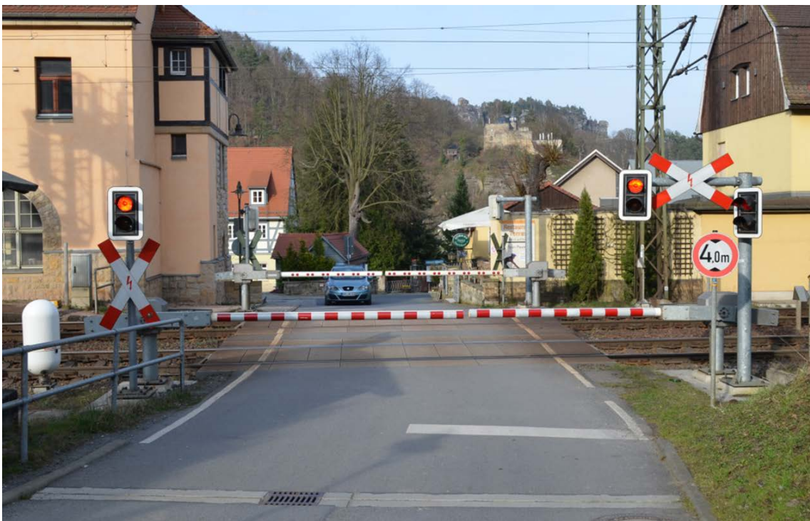
Abbildung 5: Bahnübergang mit Lichtzeichen und Schranken (mit technischer Gefahrenraumfreimeldung)
