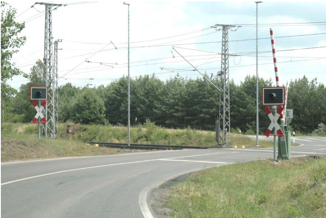
Abbildung 4: Bahnübergang mit Blinklicht und Halbschranken
